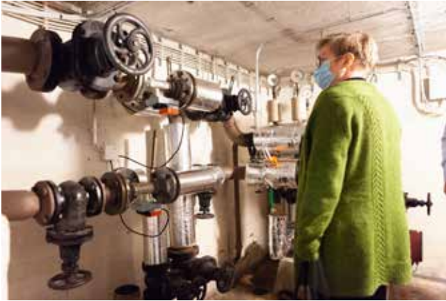
Uusi energiankierrätysjärjestelmä liitettiin kiinteistön olemassa olevaan lämmitysverkostoon. Vanhasta järjestelmästä löytyi asbestia, jota purettiin liitoksien tieltä pois. "Asbestinpurku ei ollut niin hankalaa ja kallista, kuin etukäteen pelättiin", Katri Parovuori kertoo.
