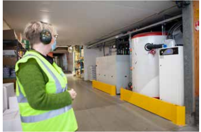
Erikoisasiantuntija Katri Parovuori kartoittaa energiankierrätyspotentialin tarkastelemalla tehtaan jäähdytystä ja lämmitystä. "Millä tavalla tällä hetkellä jäähdytetään, kuinka paljon lämpöä menee pihalle ja toisaalta, kuinka paljon lämpöenergiaa käytetään. Jäähdytyksen tehokkuudella on suora yhteys tuotantonopeuteen."
