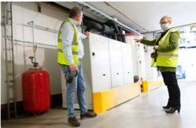
Lämpöpumppu, lämminvesivaraaja ja sähkökattilat vievät vain vähän tilaa. Uuden järjestelmän tekniikka saatiin mahtumaan käytävän reunaan. Ohi pääsee kulkemaan hyvin trukilla.
